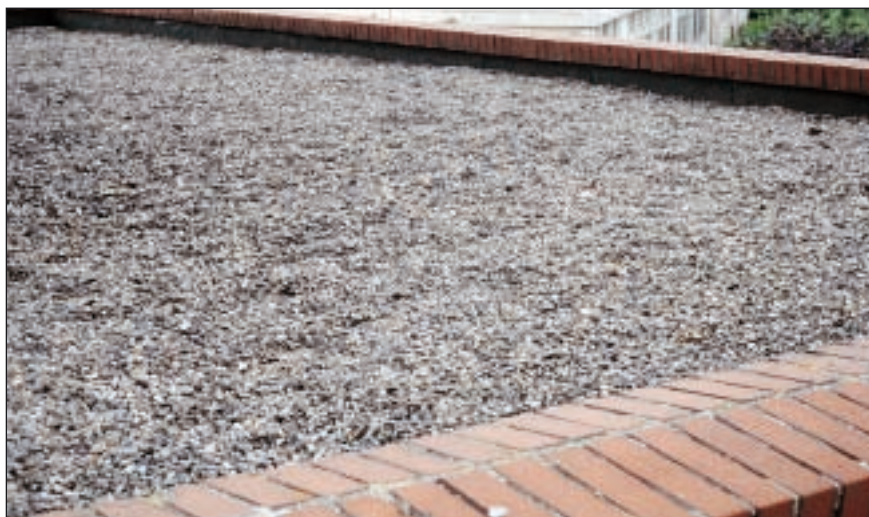
La protection de la membrane d'étanchéité est assurée par une protection lourde rapportée (une couche de gravillons).
